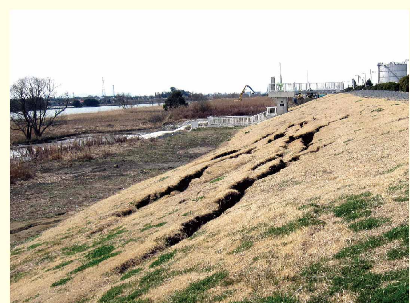
第10図 河川堤防に発生した地割れ (2011年東北地方太平洋沖地震)
