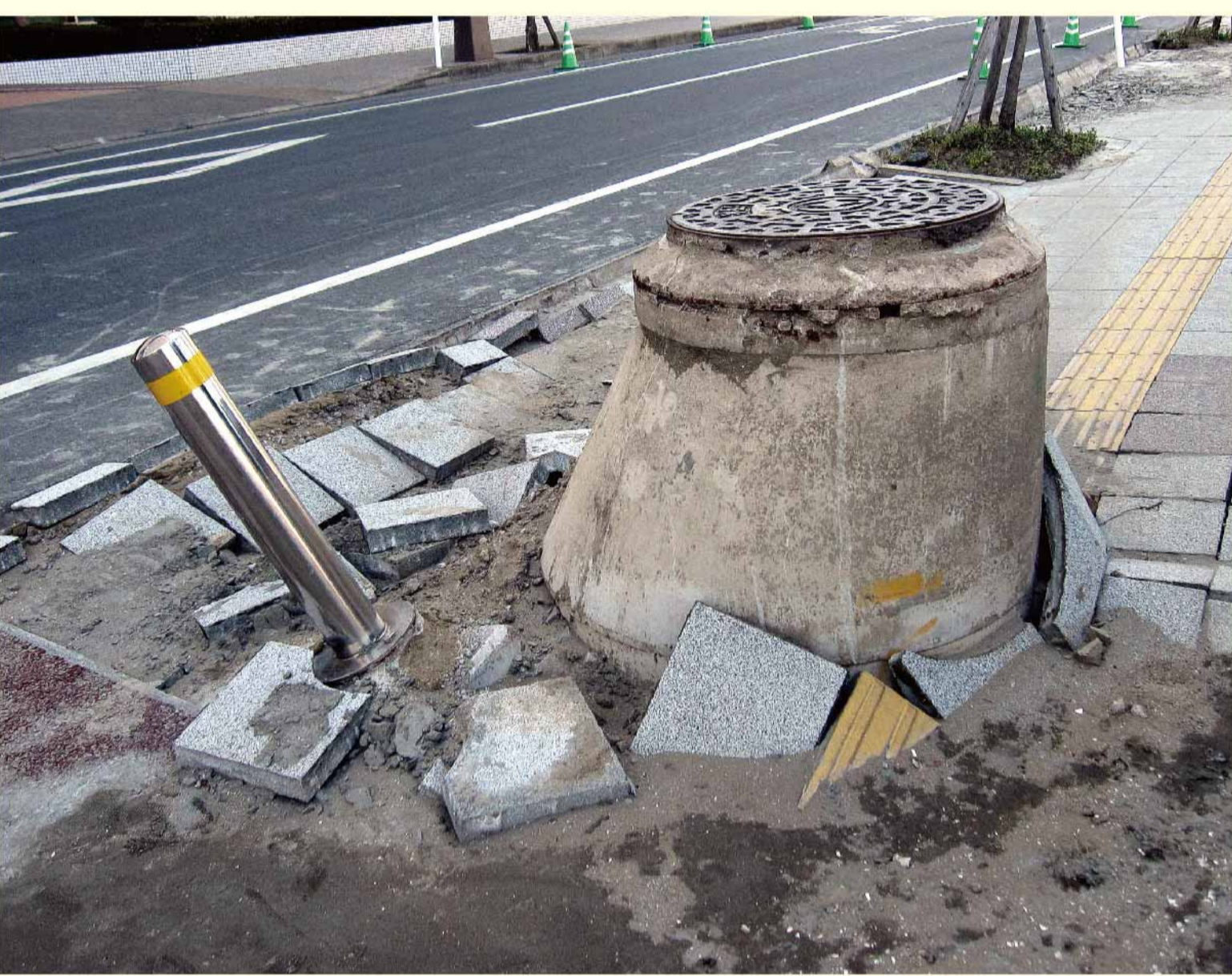
第6図 液状化で浮き上がったマンホール (2011年東北地方太平洋沖地震)
