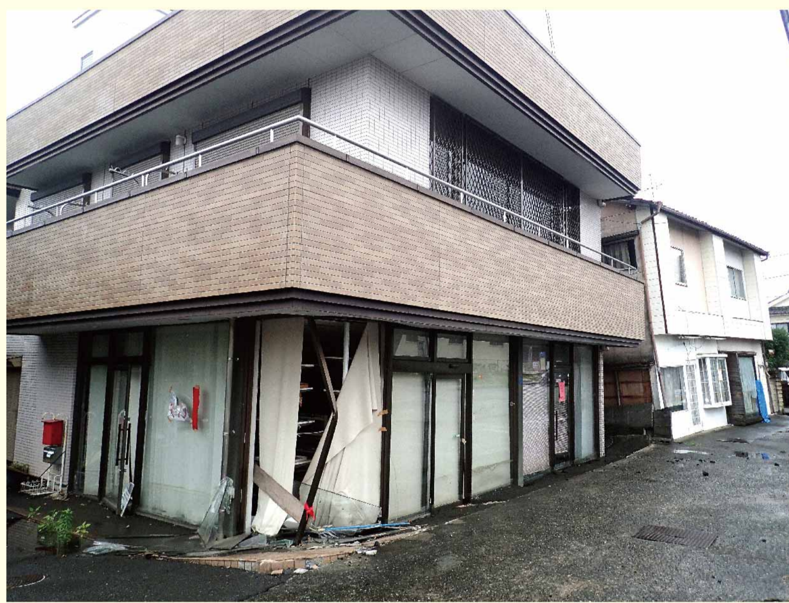
第7図 液状化で大きく傾倒した家屋群 (2016年熊本地震)
