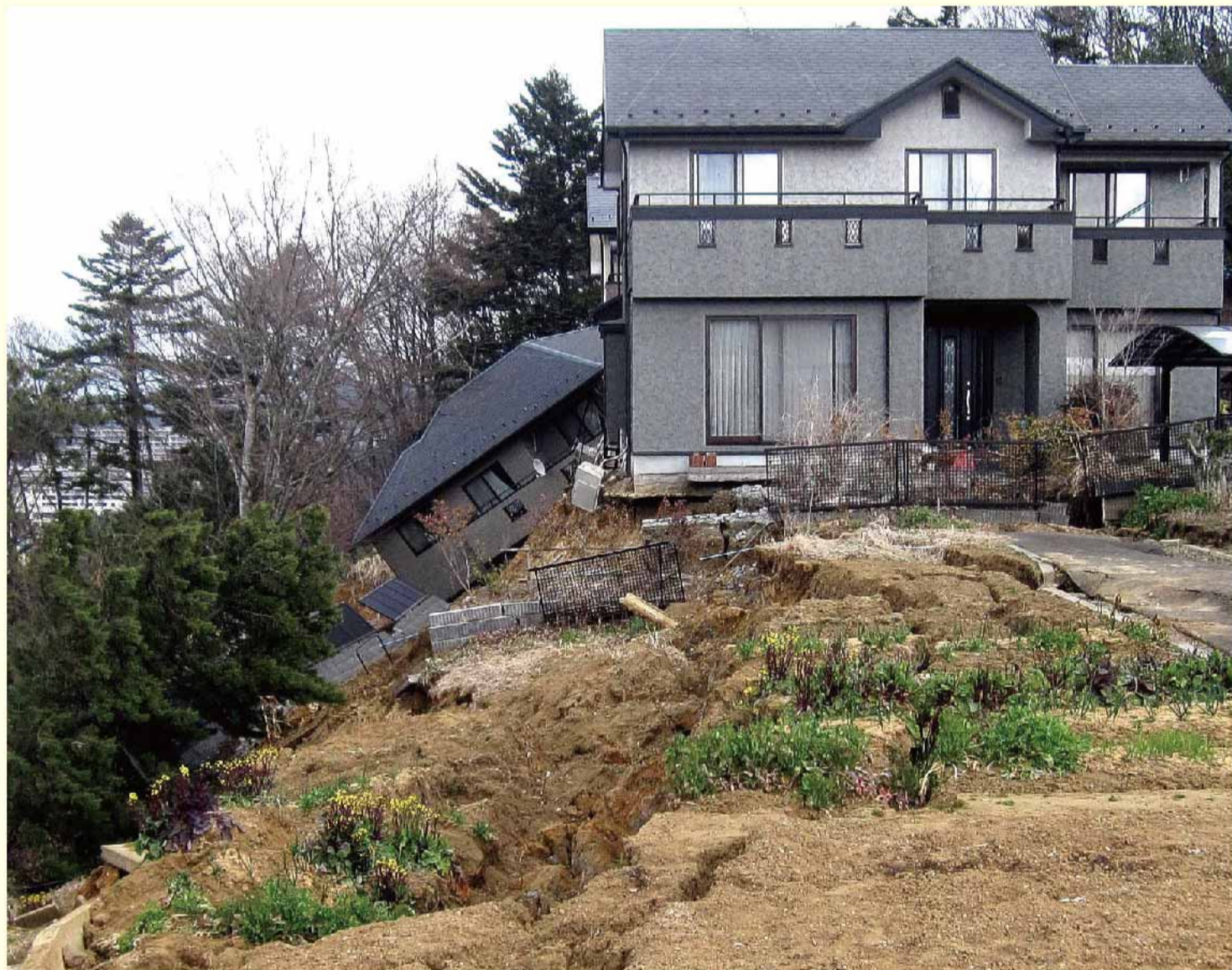
第6図 宅地盛土斜面の崩壊 (2011年東北地方太平洋沖地震)
