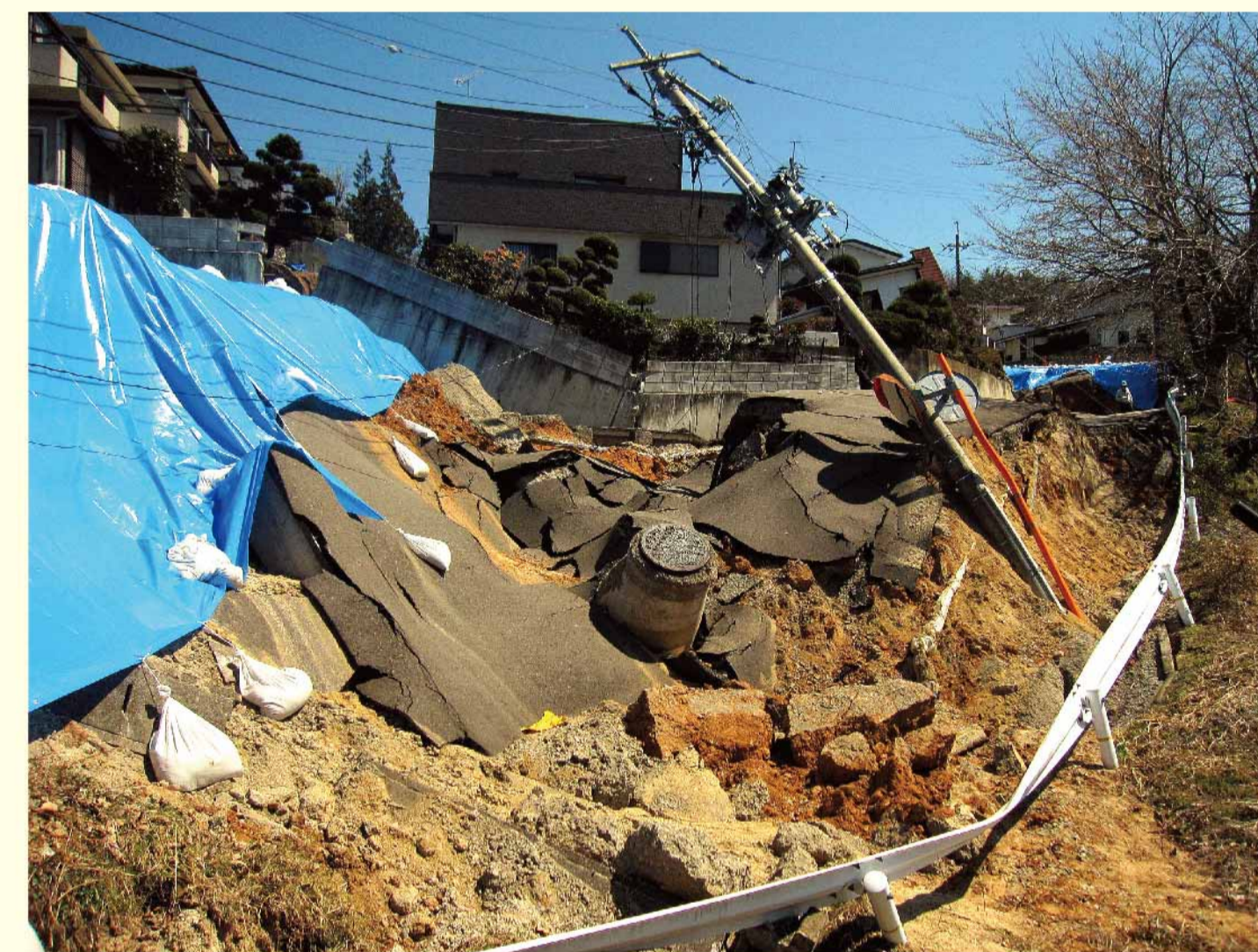
第8図 宅地盛土斜面の崩壊 (2011年東北地方太平洋沖地震)
