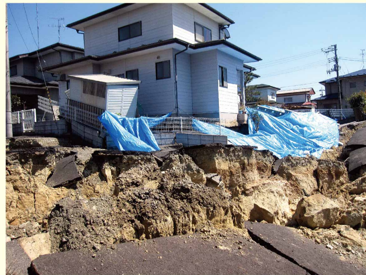
第7図 宅地盛土斜面の崩壊 (2011年東北地方太平洋沖地震)
